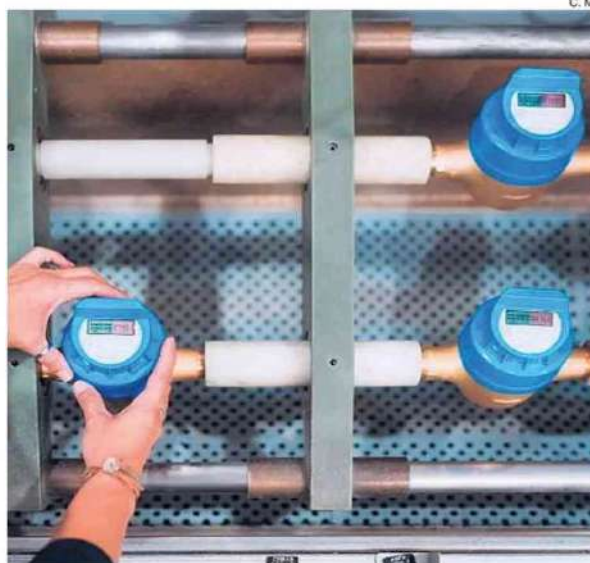
Los contadores inteligentes que está instalando Canal de Isabel II
