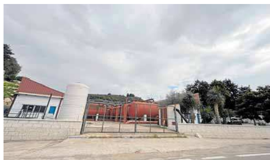
Planta potabilizadora de El Trapiche en Vélez-Málaga. E. CABEZAS
